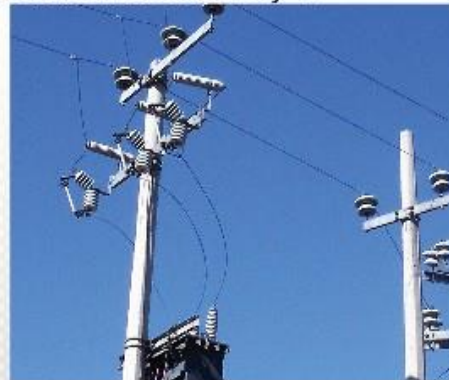
Figura 5: Eslabón fusible protegiendo a Transformador
